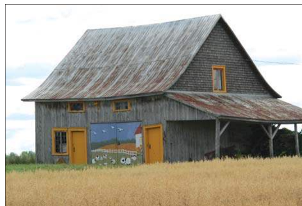
L'industrialisation de l'agriculture contemporaine laisse sur son passage de nombreux bâtiments secondaires inoccupés. Certains sont récupérés à des fins agrotouristiques ou esthétiques.
